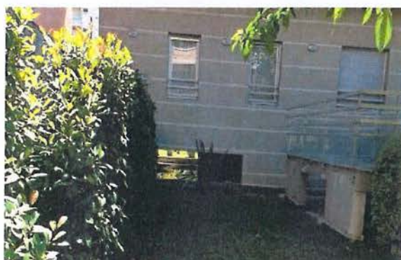
FIGURE 30 : EXEMPLE D'HABITATION FREQUEMMENT INONDEE SITUEE AU NIVEAU DU THALWEG ORIGINAL
