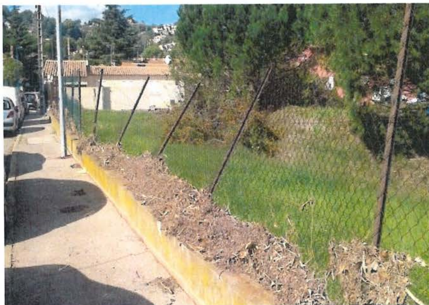
FIGURE 28 : PLOIEMENT DE CLOTURES SOUS L'EFFET DE L'EAU – CRUE DU 03/10/2015
