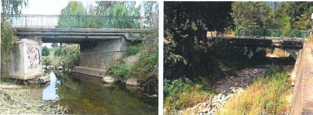
FIGURE 25 : PONT BREJNEV A GAUCHE ET PONT DU GOLF SUR LA VALMASQUE A DROITE
