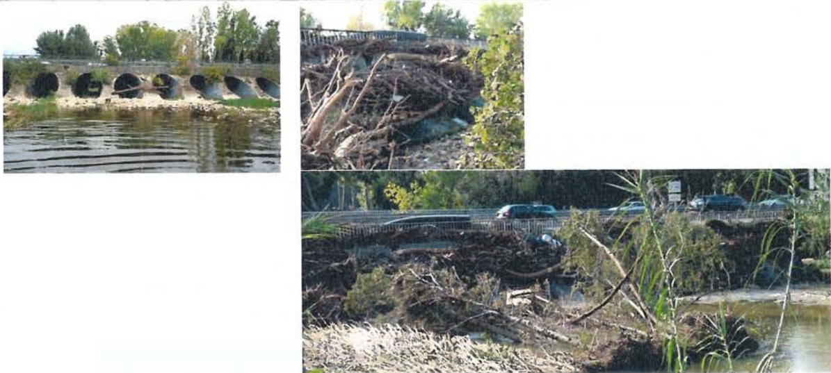
FIGURE 49 : EXEMPLE D'OBSTRUCTION DES BUSES DE L'A8 LORS DE LA CRUE DU 03/10/15
